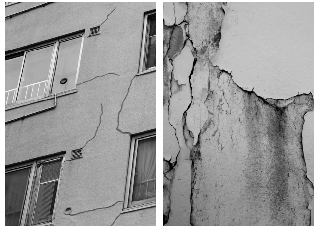
塗装の劣化や「チョーキング」、放置してはいませんか？
